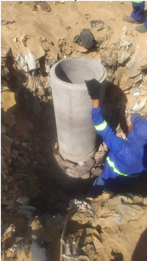
Figura 14 / foram instaladas manilhas para aliviar a produção do chorume, mas devido a área do aterro
